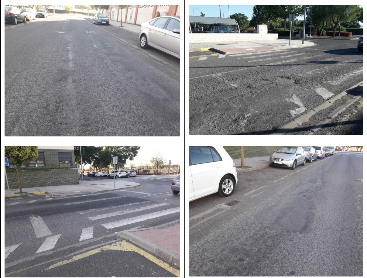
Estado del pavimento.
