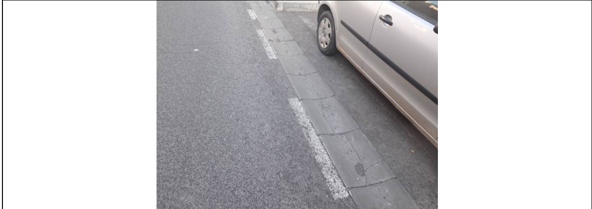
Las rigolas prefabricadas están partidas en algunos tramos.
