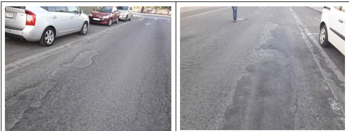
Estado del pavimento.
